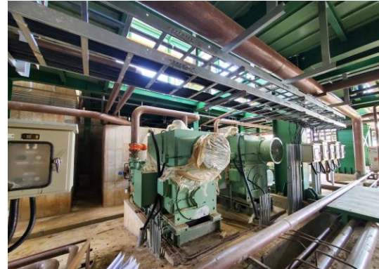
SALA DE BOMBAS
