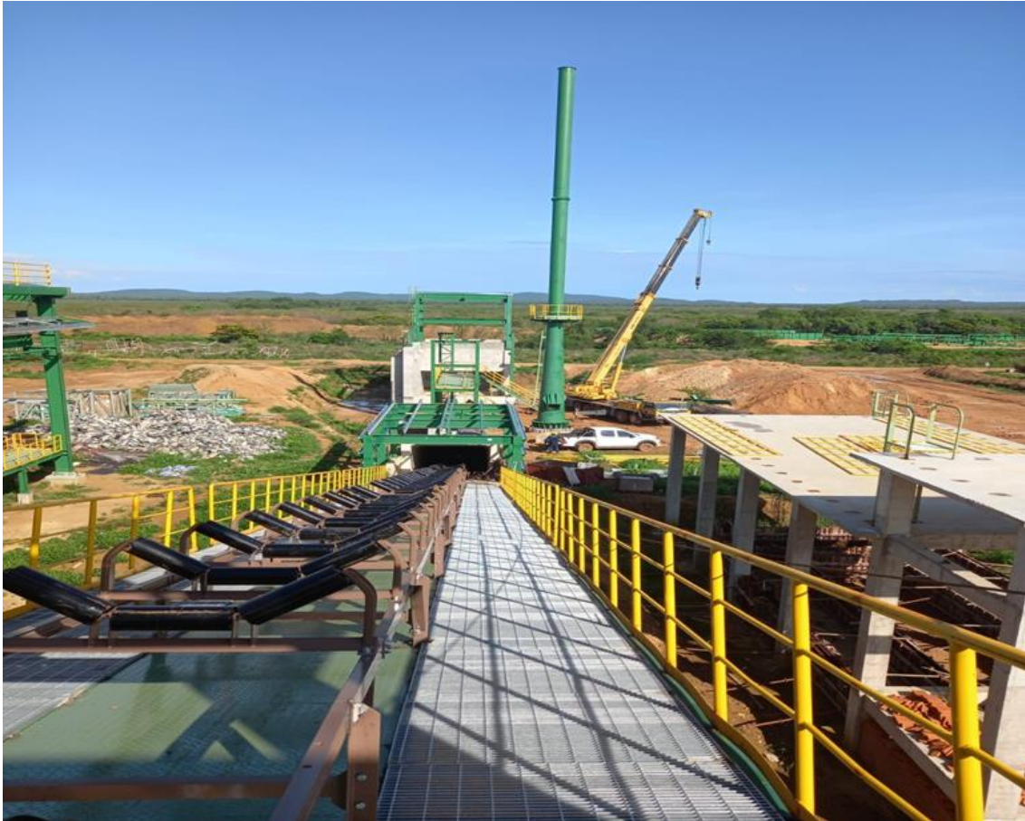
CINTA TRANSPORTADORA DEL PUNTO DE RECCEPCIÓN DE LA MATERIA PRIMA AL TALLER DE MEDIOS Y FINOS
